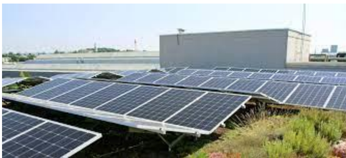
Abbildung 30: Beispiel einer Dachbegrünung mit einer PV-Anlage
